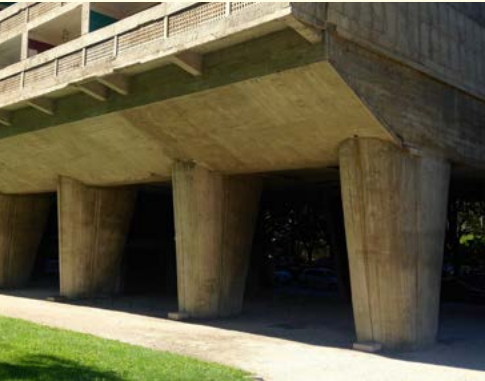
28 Trowel marks visible on the columns of Le Corbusier's Unité d'habitation, Marseille (1945).
